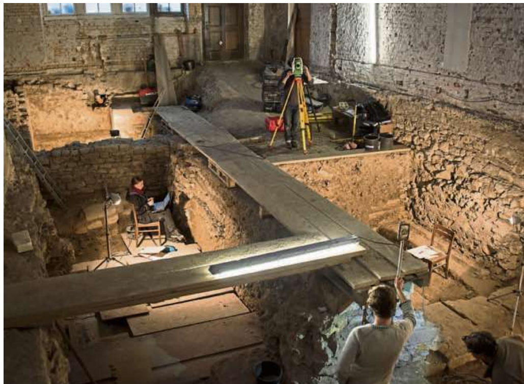
„Um mit der Kamera nah an den Details zu sein, sind wir mit in die tiefen Löcher gestiegen“, beschreibt Regisseurin Bollmann. Hier eine Aufnahme aus einem Seitenschiff. Foto: Gerhard Fleischer, DGPh
